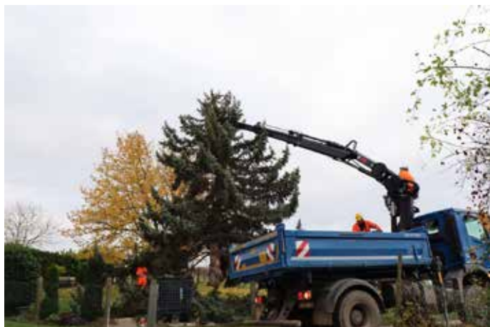
Vorbereitungen für den Abtransport des über 40 Jahre alten Baumes. Fotos: Stadt Bingen
