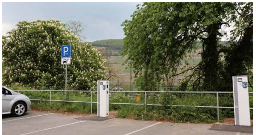
Die Ladesäulen in Bingerbrück.
