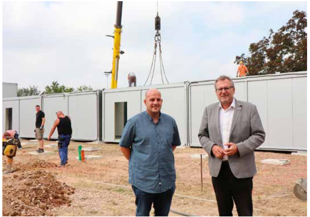
Projektleiter Stefan Bußmann und Oberbürgermeister Thomas Feser (re.) an der Baustelle für den Interims-Kindergarten. Foto: Stadt Bingen
